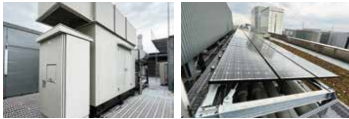
非常用発電機
